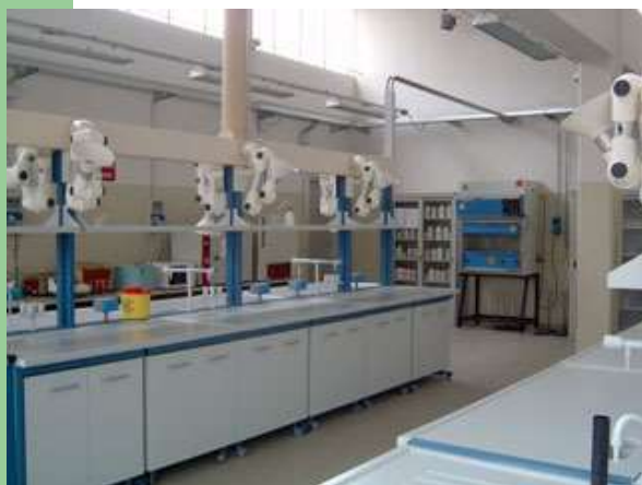
Impianto elettrico a calata o lineare
